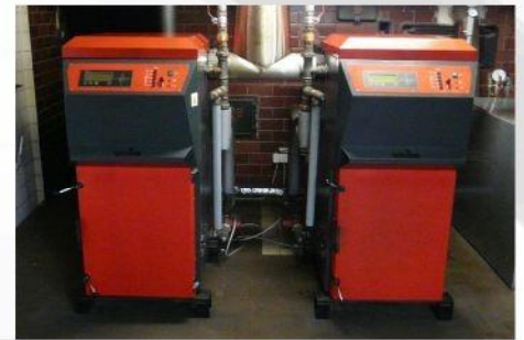
Hotel Tanečnice Pustevny Kaskáda automatických kotlů VERNER
