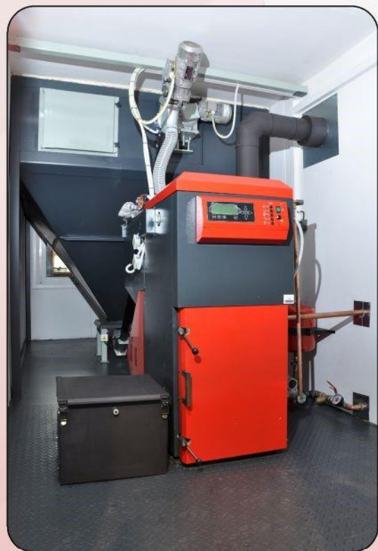
Nahoře: pohled do mobilní kotelny.
